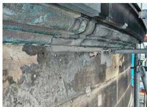
Schadensbild mit Substanzverlusten und defekten Fugen (ST)
